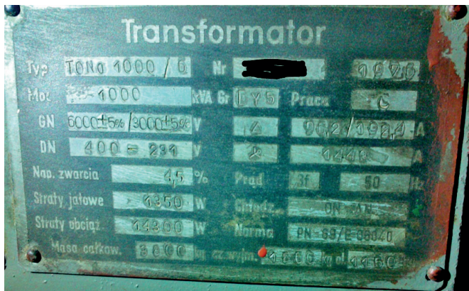
Rys. 1. Tabliczka znamionowa transformatora
